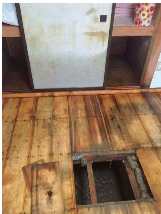
室内の被害状況も撮っておく
