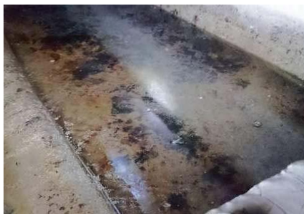
水が残って悪臭が発生する
