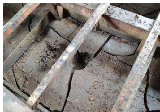
床下にたった泥（写真③）
