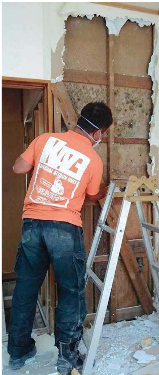
壁をはがすとカビが生えている
